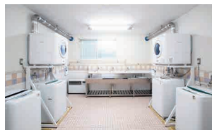
ランドリー室と乾燥機
